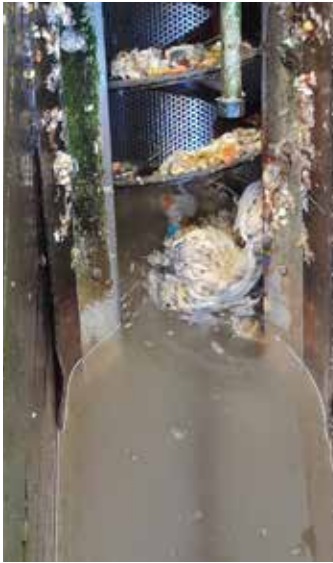
Siebrechen für Zulauf
